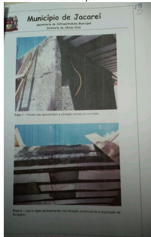
Foto 42: Fls.198/202 do processo: irregularidades como viga preenchida com madeira, falta de verga e contraverga em vãos, viga com má vibração e exposição de ferragem
