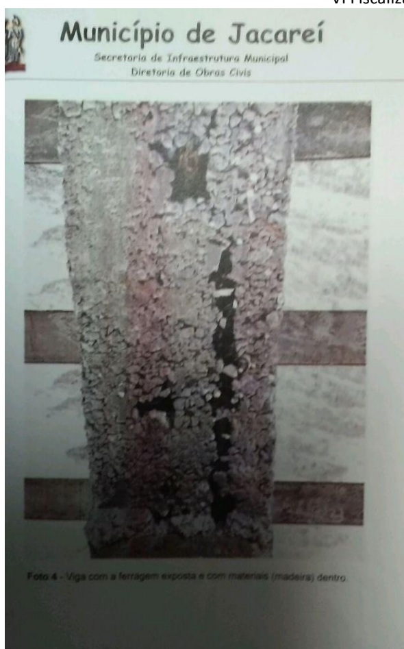
Foto 35: imagem extraída do processo onde se relata vigas com ferragem exposta e com madeira em seu interior
